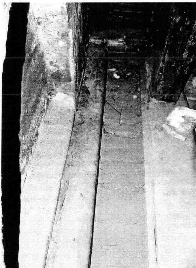
belka przy ścianie wieży wymagająca wzmocnienia - widoczne uszkodzenia
