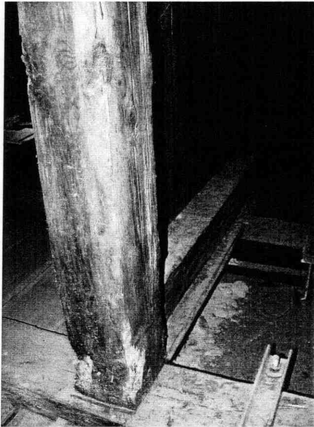
poziom I poddasza - uszkodzona podstawa słupa
