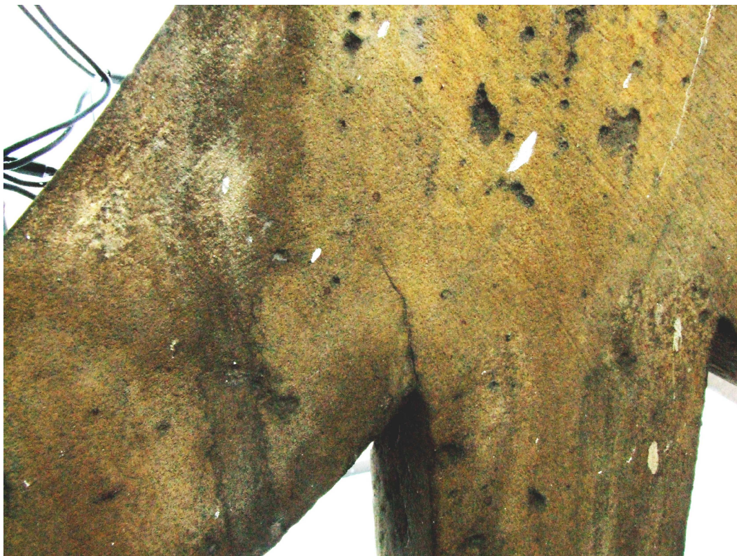
fot. 17 balustrada, widoczne spękania
