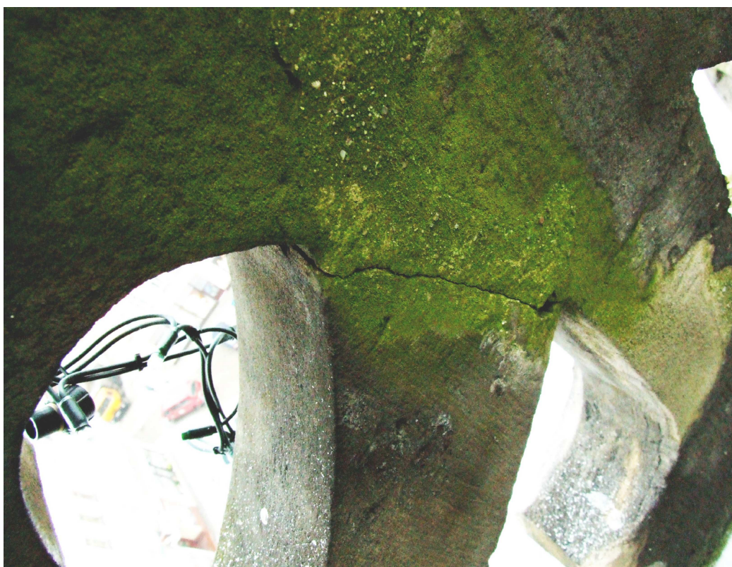
fot. 12 balustrada, widoczne spękania
