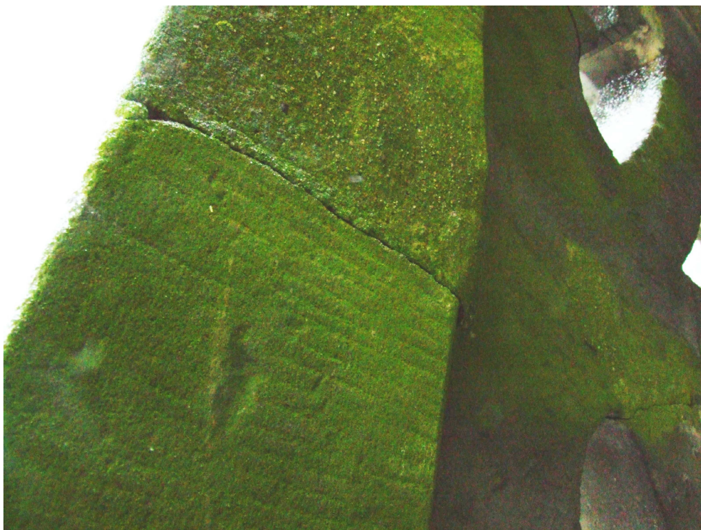
fot. 11 balustrada, widoczne spękania
